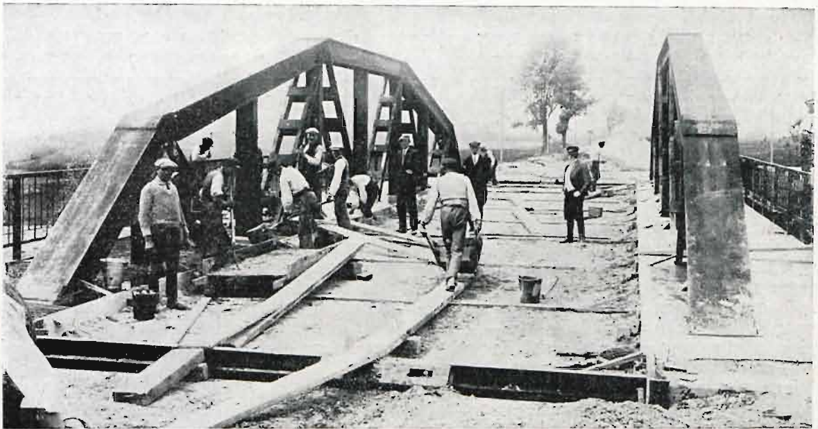
Most na rzece Słudwi w Łowiczu przed ukończeniem (konstrukcja spawana już gotowa)
