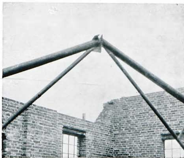
Fig. 20. Assemblage des arbalétriers des fermes en tubes soudés supportant la toiture des usines Perun à Varsovie.
