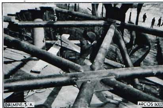
Fig. 23. Détail d'un nœud de contreventement horizontal de la tour Littoria. (Cliché Arcos.)
