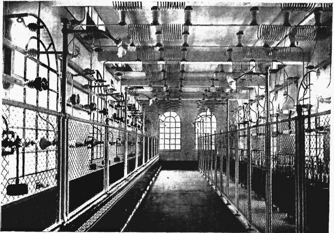
Rys. 19. Ochronniki kondensatorowe 32 kV w Hauterive.
