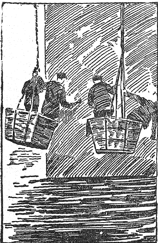
Jeden z mostów kolejowych w Londynie, jest obecnie odnawiany. Robotnicy, zajęci przy malowaniu filarów, zawieszani są w koszach ponad wodą, jak to widzimy na naszej ilustracji.
