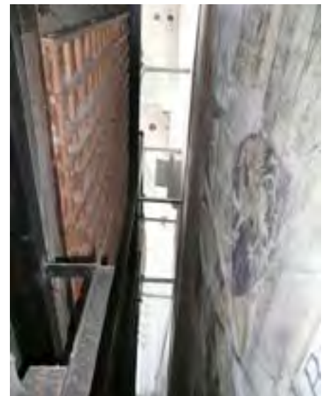
Fot. 3. Prezbiterium katedry oliwskiej – ściana północna. Sposób zachowania malowidła ściennego poprzez odsunięcie barokowego zespołu od ściany z dekoracją. Stan z 2011 r.
