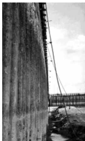
Odształcona ścianka szczelna Fot. Archiwum autora
