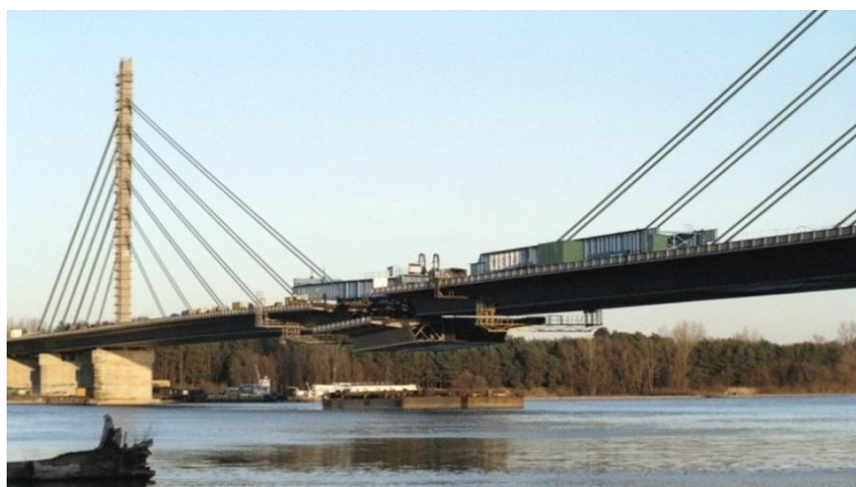
Fot. 6.9. Most wantowy przez Wisłę w Płocku, montaż zamykającego środkowego segmentu mostu
