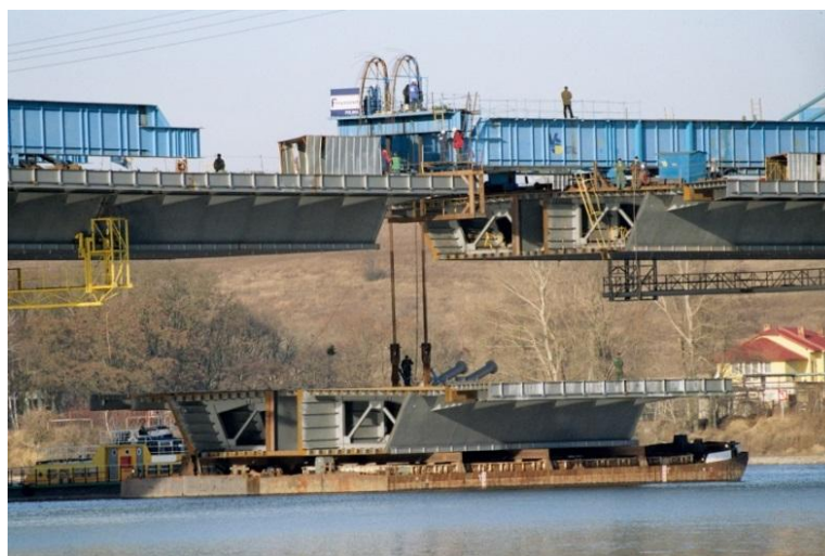
Fot. 6.8. Most wantowy przez Wisłę w Płocku, podnoszenie zamykającego środkowego segmentu mostu
