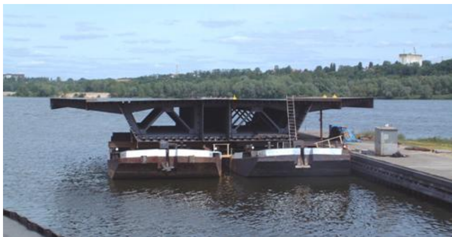
Fot. 6.4. Most wantowy przez Wisłę w Płocku, sekcja pomostu w trakcie transportu wodnego na pontonach
