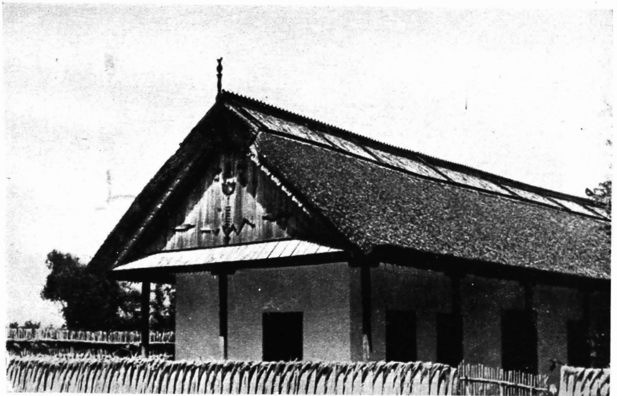
127. Mahmudia. Casă cu timpanul din scinduri cu ornamentație aplicată și streășină peste prispă întoarsă pe latura îngustă
