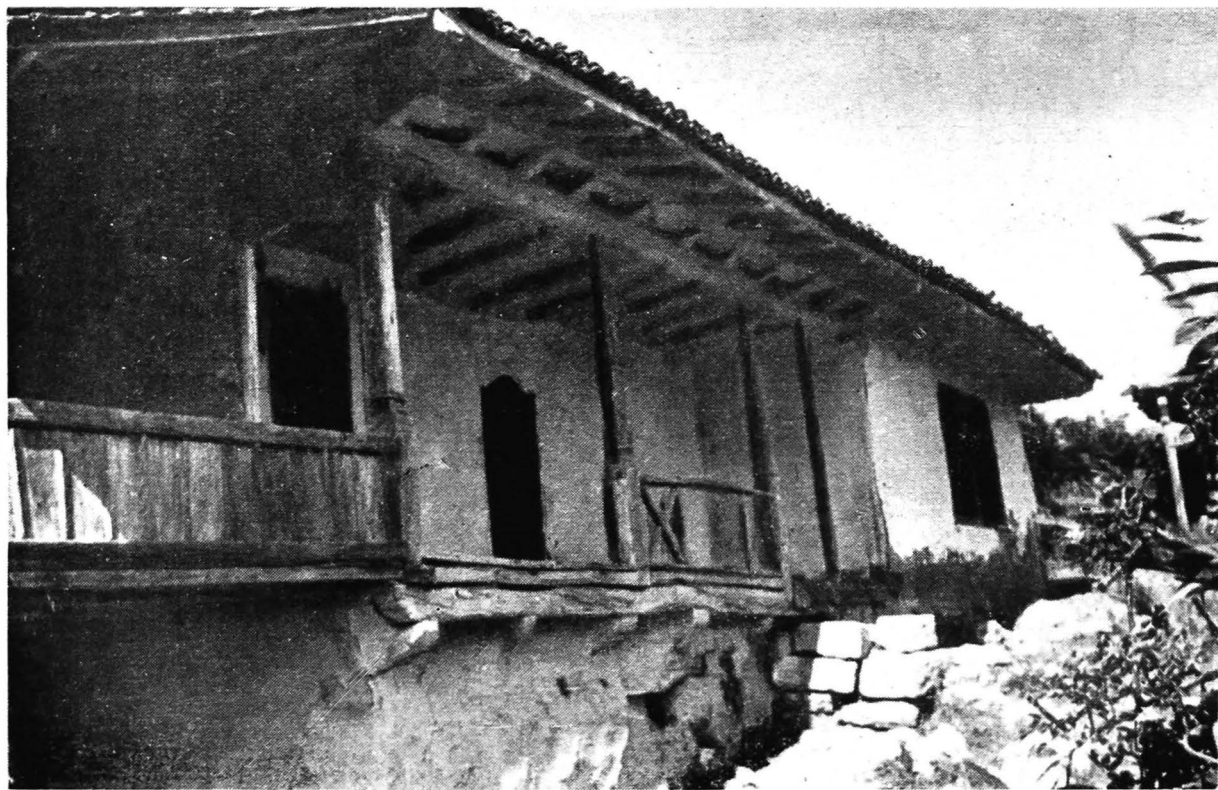
62. Cuiungiuc. Detaliu de fațadă și streașină. Prispă puțin ieșită pe capătul grinzilor. Streașina este lărgită prin prelungirea câpriorilor peste grinzile tavanului
