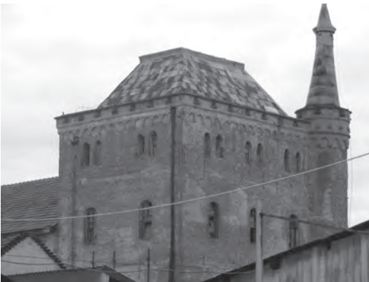
Fig. 4. Relicva ansamblului arhitectural Fabrica de spirt și drojdie „Adolf Moskovits și Fiii” . Starea sa de conservare este deteriorată. Chiar și așa, are o reală valoare istorică și se pretează clasării în categoria de monument industrial.
