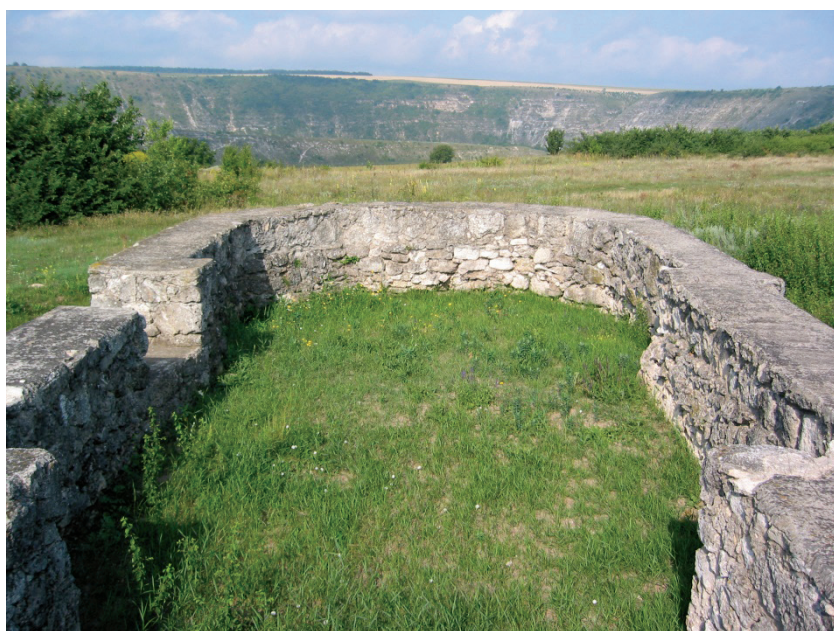
Fig. 14. Fundațiile bisericii de piatră de la Orheiul Vechi consolidate de restauratori, vedere dinspre est (foto: Gh. Postică).
