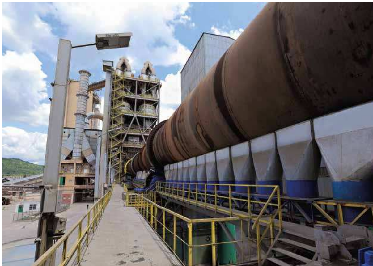
Cuptor de clinker, vedere de la capul cald spre capul rece
