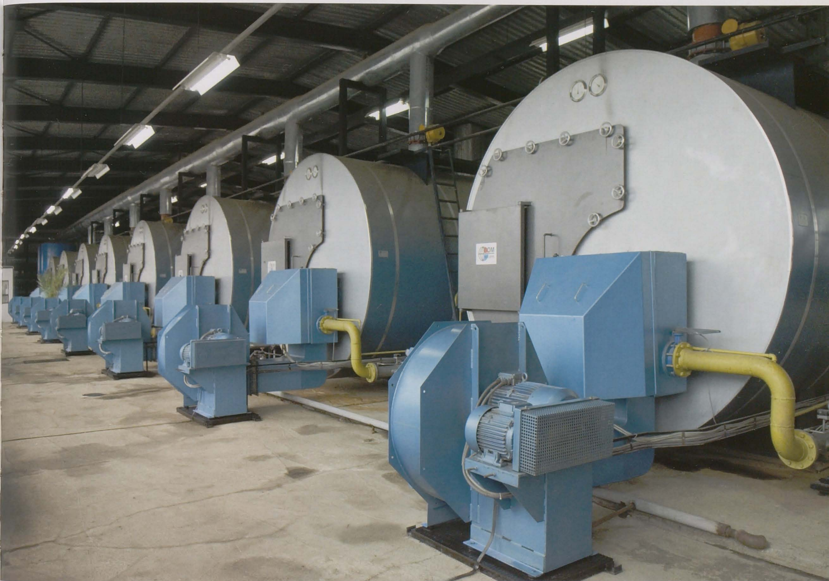
Sala boilerelor care asigură încălzirea serelor
