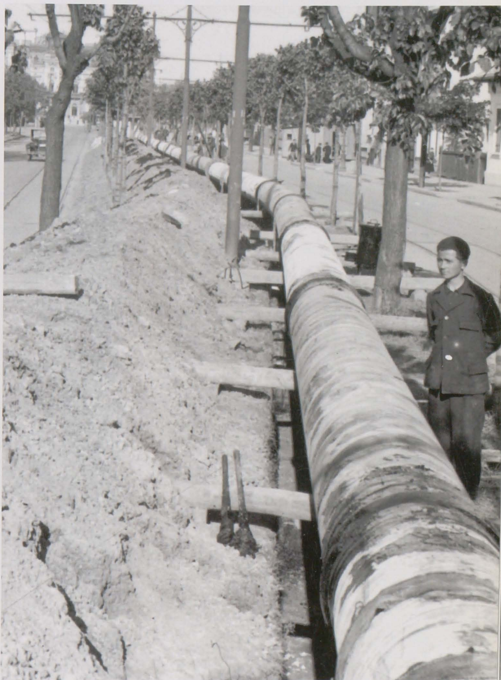
Montarea conductelor de gaze naturale în București, în Bd. Basarab (zona cuprinsă între str. dr. Felix și Piața Victoriei), 22 mai 1943
