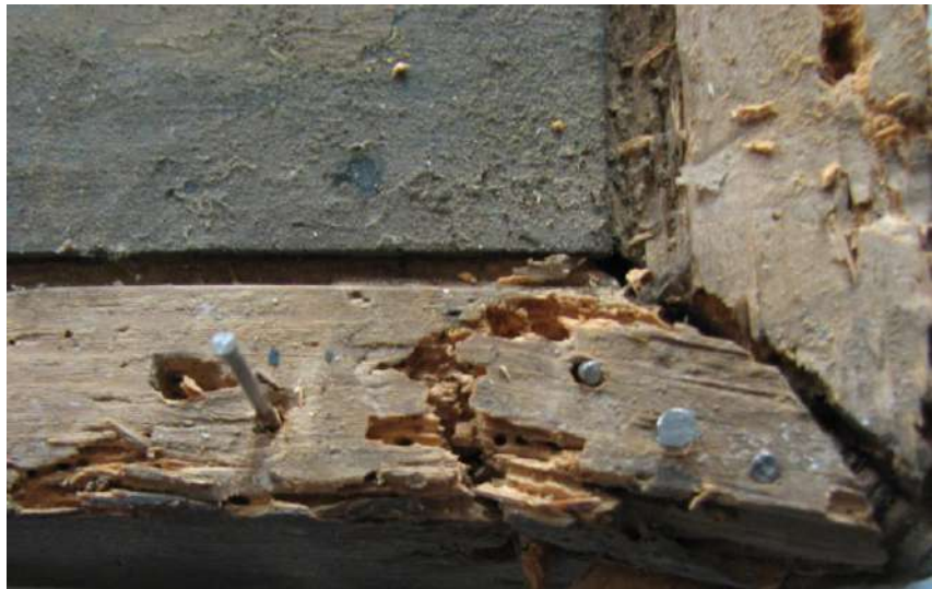
Fragilizări ale îmbinărilor ramei
