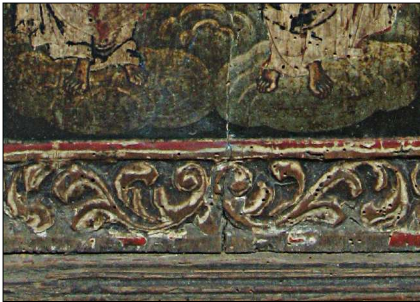
Fisuri și crăpături (detalii nr. inv. 524; 519)
