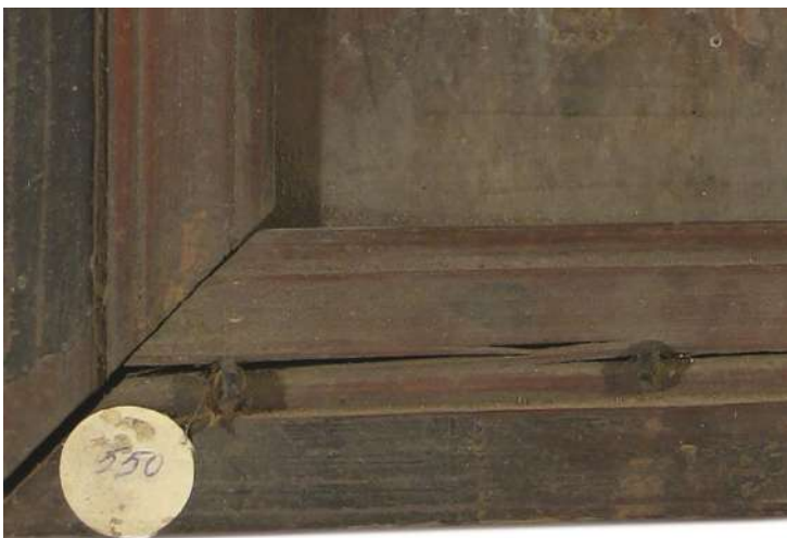
Pierderi de material lemnos, fragilizarea îmbinărilor ramei, cuie metalice neconstitutive care au dus la fisuri și crăpături în structura lemnului, agățătoare neconstitativă (detalii nr. inv. 550)
