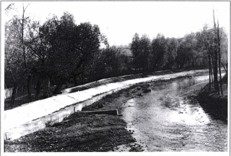
Fig. 40. Dig pe râul Mehadica (localitatea Cuptoare) împotriva inundațiilor și a eroziunii laterale
