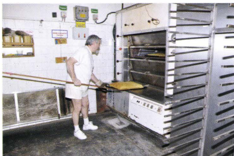
Cuptorul electric din brutărie
