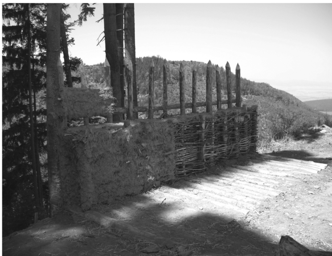
Tabăra studențească de arheologie și arhitectură experimentală. Aspecte din timpul construirii zidului cu palisadă
