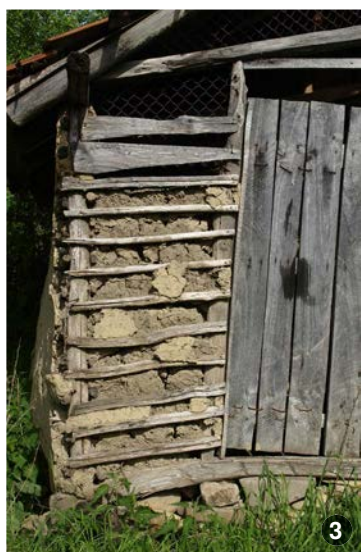
Detaliu schelet din pari de lemn înfipti în pământ cu șipci și umplutură de pământ.
