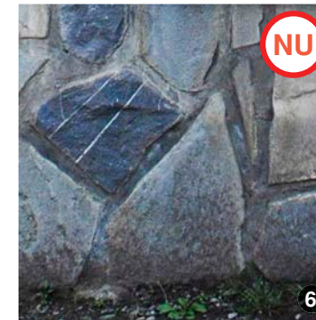
AȘA NU: Placare a soclurilor realizată pe scară largă în zonă, care nu se încadrează în specificul local.
