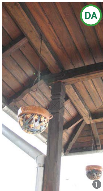
AȘA DA: Realizarea streșinii din lemn după dimensiunile locale este varianta optimă pentru clădirile de orice dimensiune.
