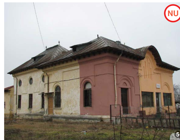
AȘA NU: Se interzice folosirea culorilor stridente pentru zugrăvirea fațadei. Aceasta distonează profund cu caracterul natural al plasticii fațadei. Culoarele uzuale care fac obiectul acestei greșeli sunt: roșu, roz, violet, portocaliu, verde-aprins, galben-citron etc.
