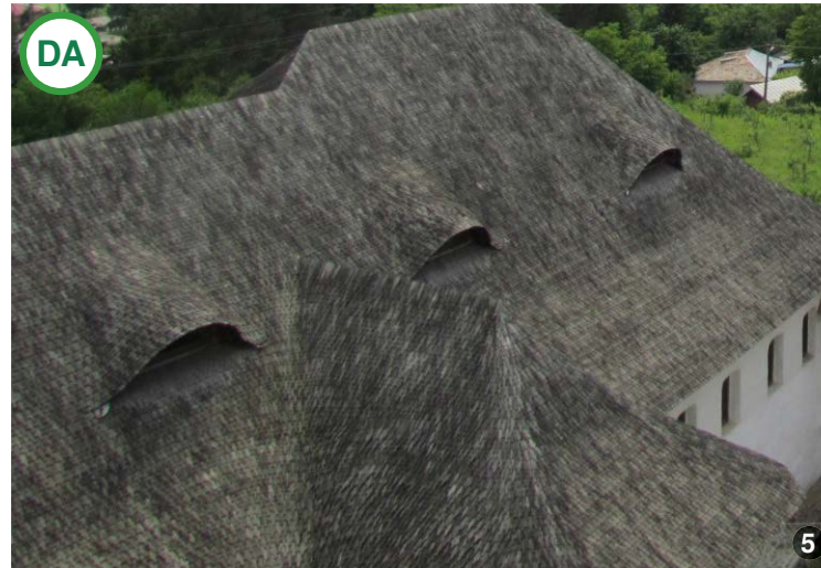
AȘA DA: Clădire cu gabarit mare unde s-a utilizat învelitoare de șindrilă. Este de remarcat importanța unei învelitori istorice în peisajul satelor. Poate fi utilizată și pentru diverse funcțiuni care necesită o suprafață construită mare: pensiuni, școli, birouri, clădiri administrative, centre culturale etc.
