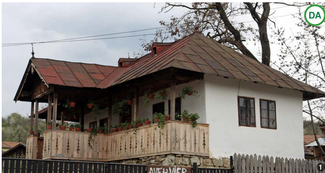
AȘA DA: Restaurarea parapetului prispei sau folosirea de material nou pentru revenirea la imaginea originală.
