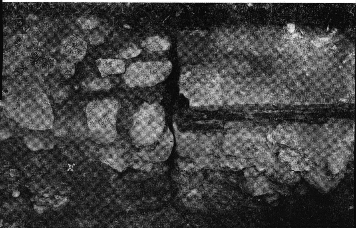
Fig. 5. Turnul nr. 1 (c. 1340): 1, 3, latura N (cu detaliu, colțul SV); 2, latura S, detaliu; Se disting (x) plombele de legătură ale fundației turnului nr. 2 (c. 1517).
