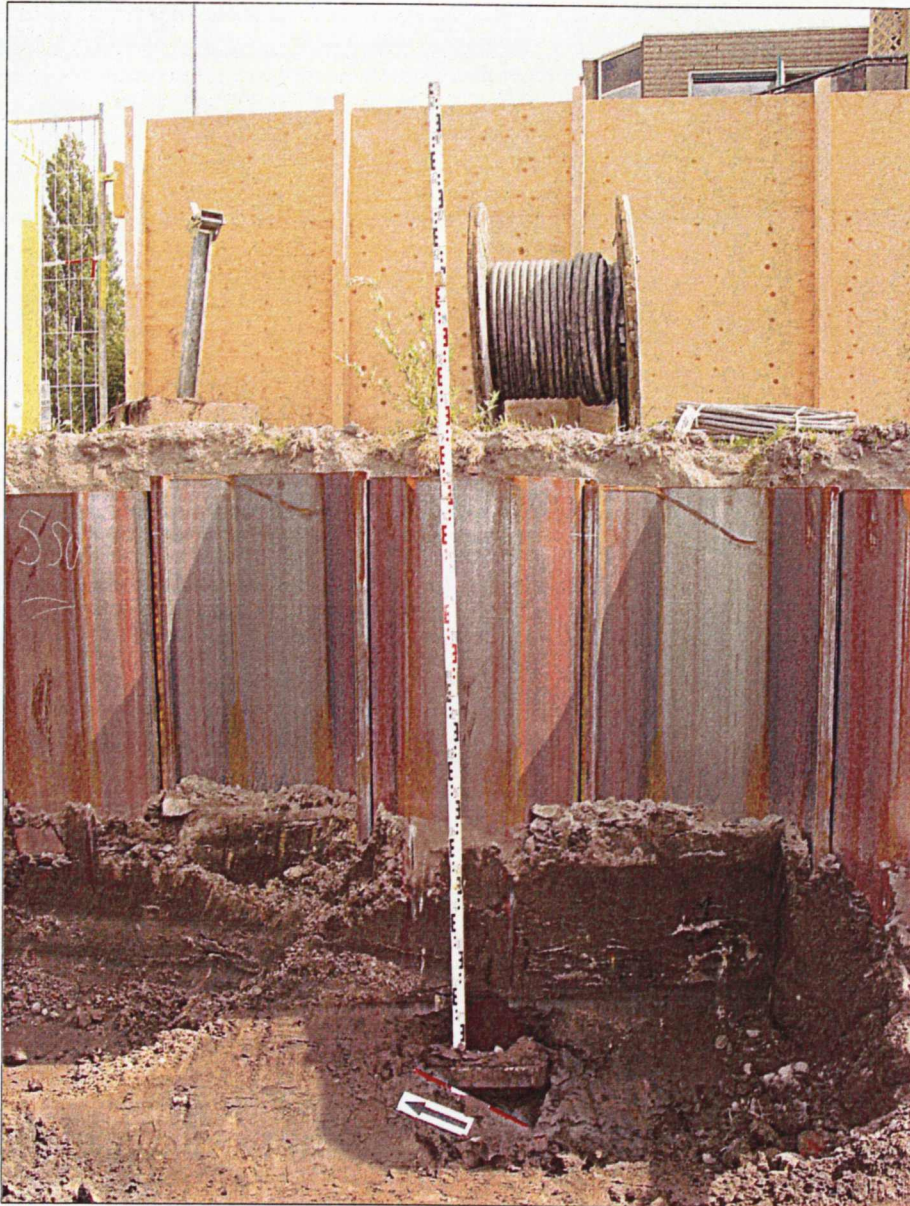
Figuur 4: Betonnen plaat en ander puin in diepe verstering.
