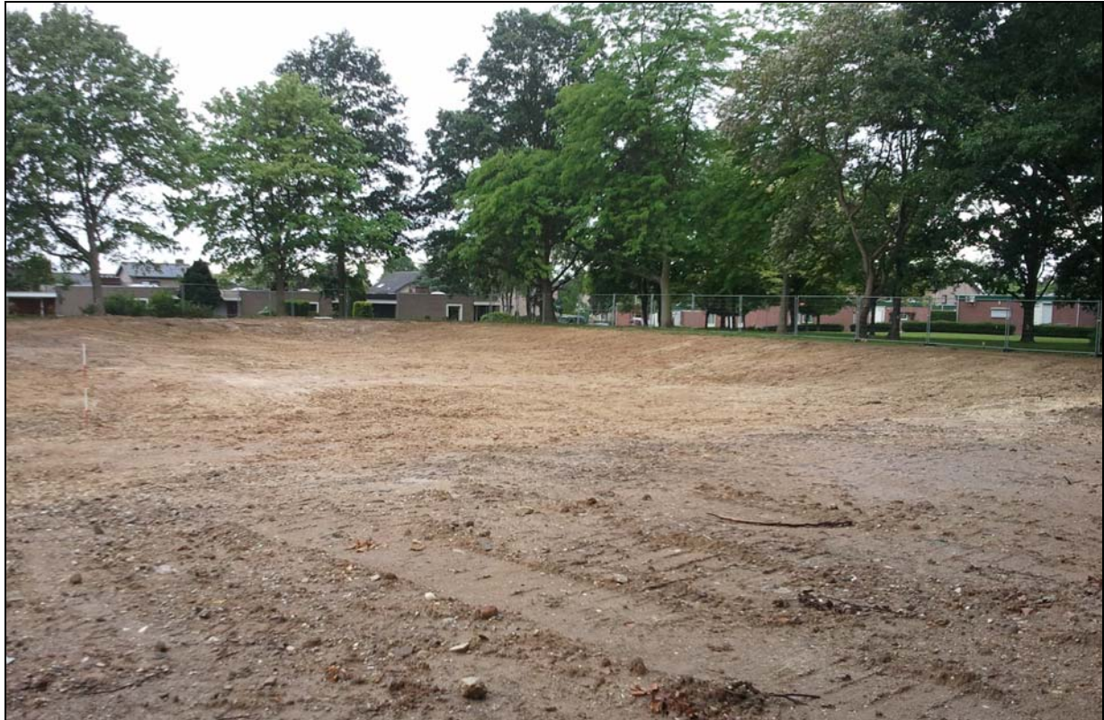
Figuur 18: Zicht op het bouwterrein met ontgraving vanaf boorpunt twee in zuidwestelijke richting. Op de achtergrond het parkje ter plaatse van het westelijke deel van het plangebied.
