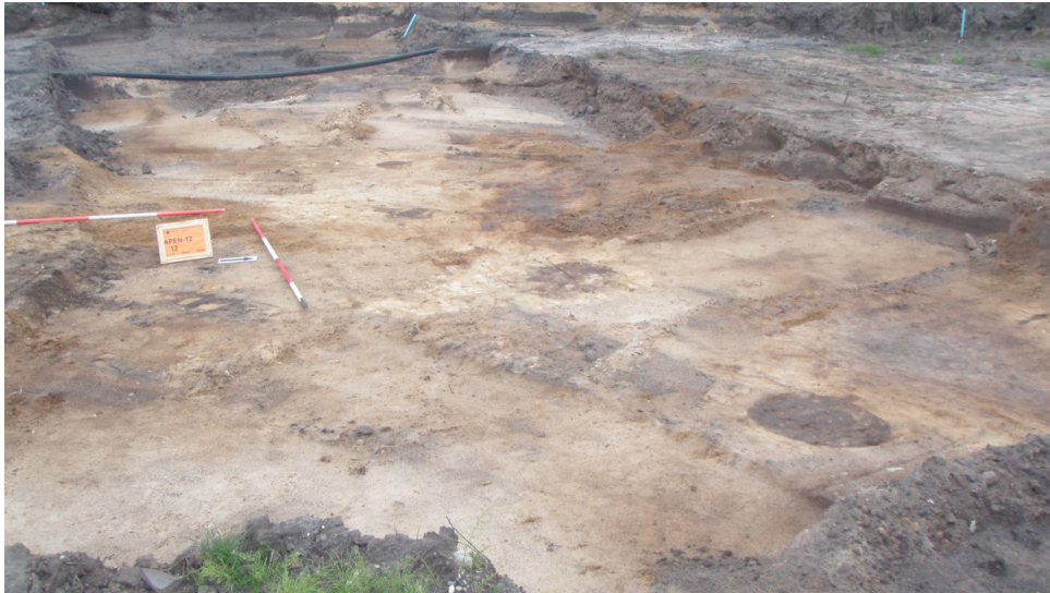
Afb. 5. Het westelijk deel van het plangebied bij aanvang van de opgraving. Tijdens de sanering was het archeologische sporenvlak reeds deels afgegraven.
