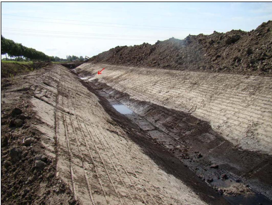
Afbeelding 12. Overzichtsfoto van de zone tussen de watergang en de meest oostelijke dam (zone Oost-c). Op slechts één locatie werd in deze zone een moerneringskuil aangetroffen (zie rode pijl). Foto (Fotonummer 16) genomen naar het westen.
