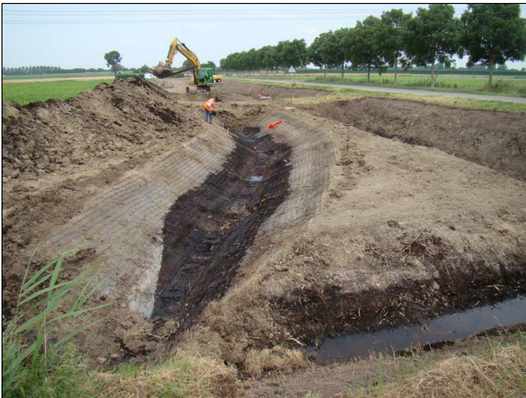
Afbeelding 9. Overzicht zone Oost-a. De slootbodem is hier ingegraven tot in het Hollandveen. De Afzettingen van Calais bleven hier buiten bereik. De schuin verlopende top van het Hollandveen in de eerste meters betreft de ingraving van het talud van de reeds bestaande sloot. Foto (Fotonummer 7) genomen naar het noordoosten.
