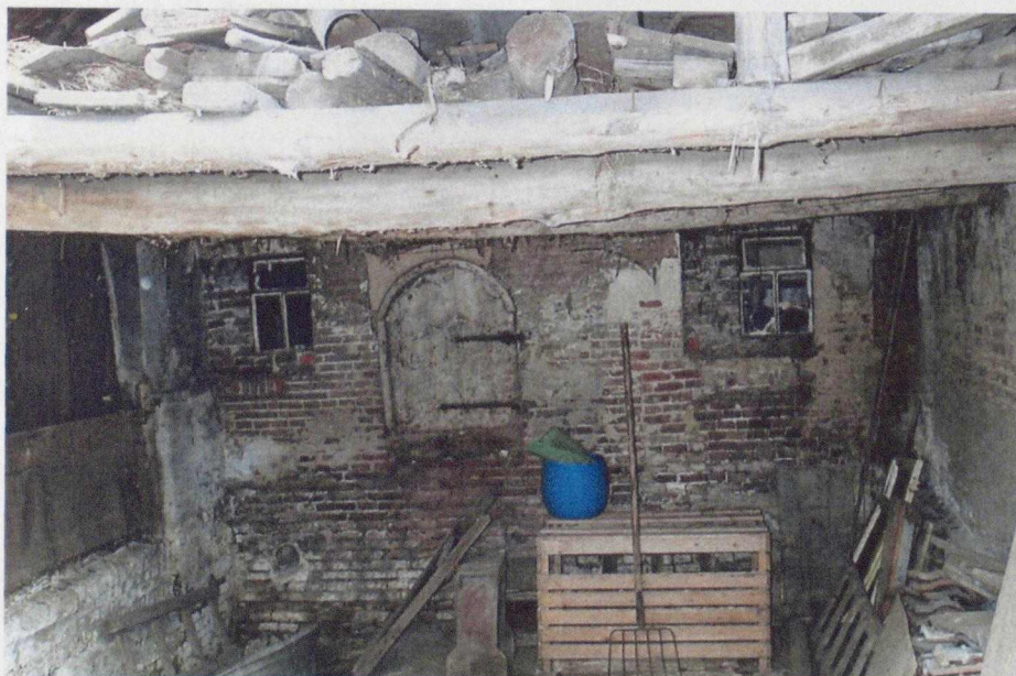
Afb. 9 Begane grond van de wagenschuur waarin een deel van de achtergevel van het hoofdbouwwerk zichtbaar is (foto BAAC).
