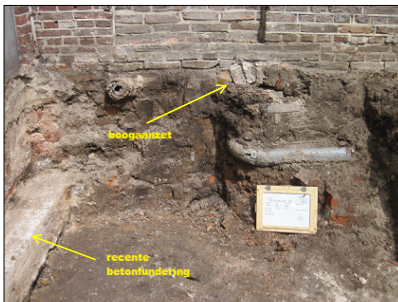
Afbeelding 49. Foto van het oostprofiel van werkput 4, de huidige muur en hierin een boogaanzet, die mogelijk in verband staat met spoor 48 en 50
