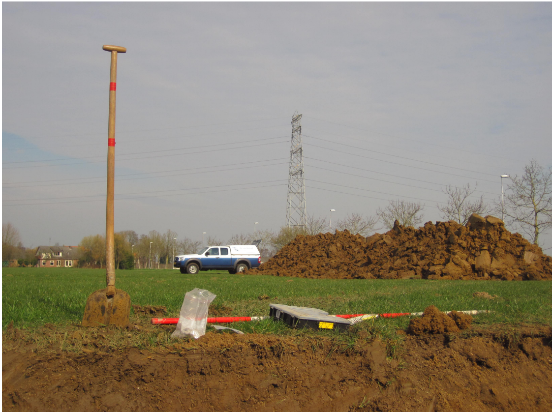
Figuur 2. Zetten, Zetten-Zuid: het plangebied tijdens de werkzaamheden. De foto is genomen vanuit werkput 3 richting het noorden.
