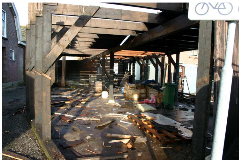
Afb. 9. Het interieur van de schuur tijdens de sloop, gezien naar het noorden.
