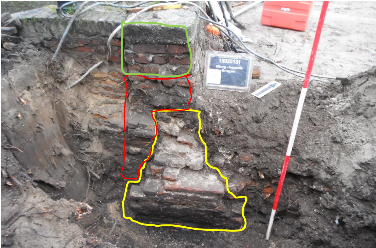
Foto van de fundering en opgaand werk van het brugfront. In geel omlijnd de laatmiddeleeuwse fundering in rood omlijnd de muur uit de 18 de /19 de eeuw (zelfde steen in muur als bij de kademuren) en in groen de 20 ste eeuwse vernieuwing in machinale steen. Foto Peter Wemerman, bewerking F. Haans.
