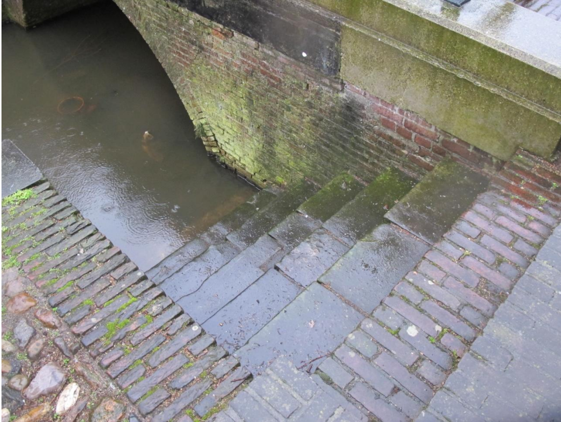
Trap met natuurstenen treden bij het brugfront met betonnen bovendeel van de brug bij de kruising Jufferenstraat en Beekstraat. FH MAB 2015
