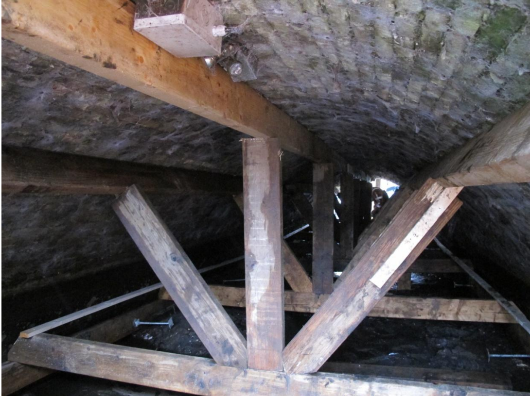
Het gewelf van de brug van de Kinsbergenstraat tijdens de werkzaamheden. FH MAB 25-2-2015
