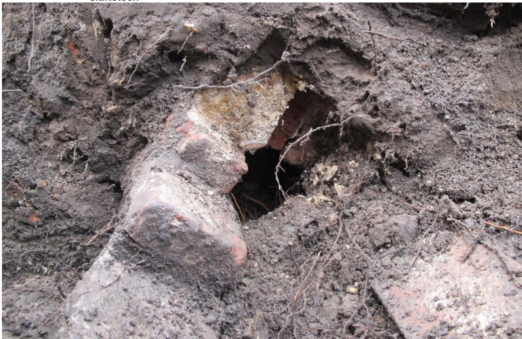
Afbeelding 12 werkput 1, aanzicht van de bakstenen duiker of riool met in de bovenzijde de trapeziumvormige sluitsteen
