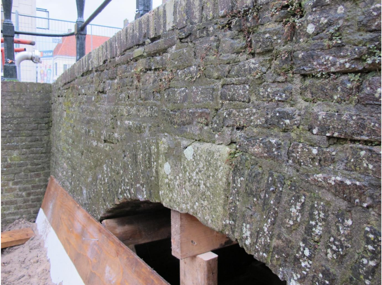
Bij het brugfront van de brug van de Van Kinsbergenstraat is alleen de rollaag boven in machinale steen vernieuwd. Voorheen lagen hier op het front natuurstenen dekplaten. FH MAB 25-2-2015
