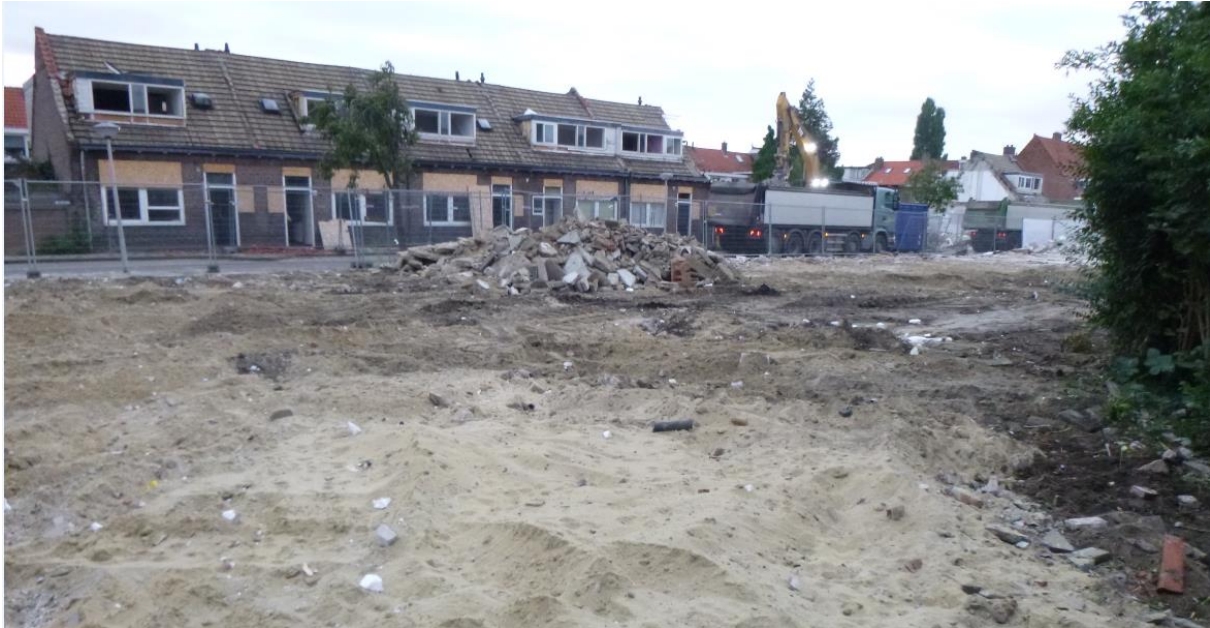
Figuur 1. De Van Speykstraat ten tijde van de sloop van het oostelijke woonblok. Het westelijke blok (op de voorgrond) is reeds gesloopt en de vloeren zijn hier verwijderd.
