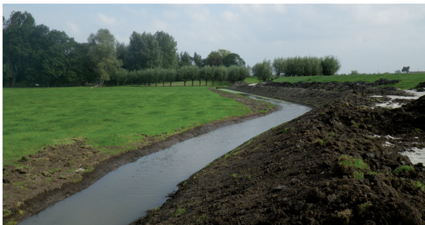
Afbeelding 7: door een beschadigde watervoerende buis kon in het oostelijk deel van de teensloot alleen de top onderzocht worden.
