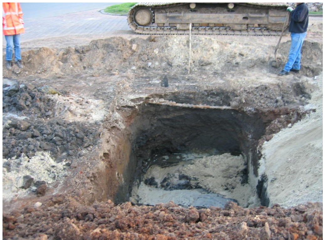
Afbeelding 3: De vulling van een waterloop ter plaatse van de ontgraving van de olievrontreiniging. Iets rechts ervan, maar vanwege instortingsrisico met zand opgevuld, werd de buiteninsteek waargenomen.
