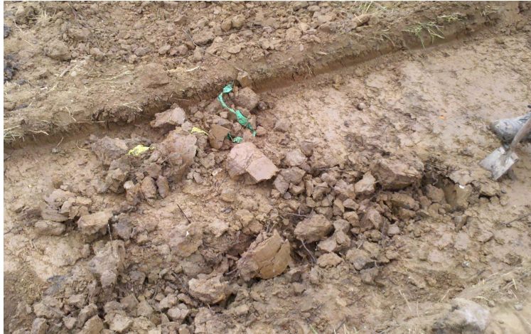
Figuur 4. Langerak, SLA-Dijkversterking: Foto van de gedeeltelijk uitgegraven leidingsleuf. De breedte van het bovenste niveau is 100 centimeter. In verband met de ligging van telefoon- en TV-kabels werd het hele tracé met de schep voorgegraven.
