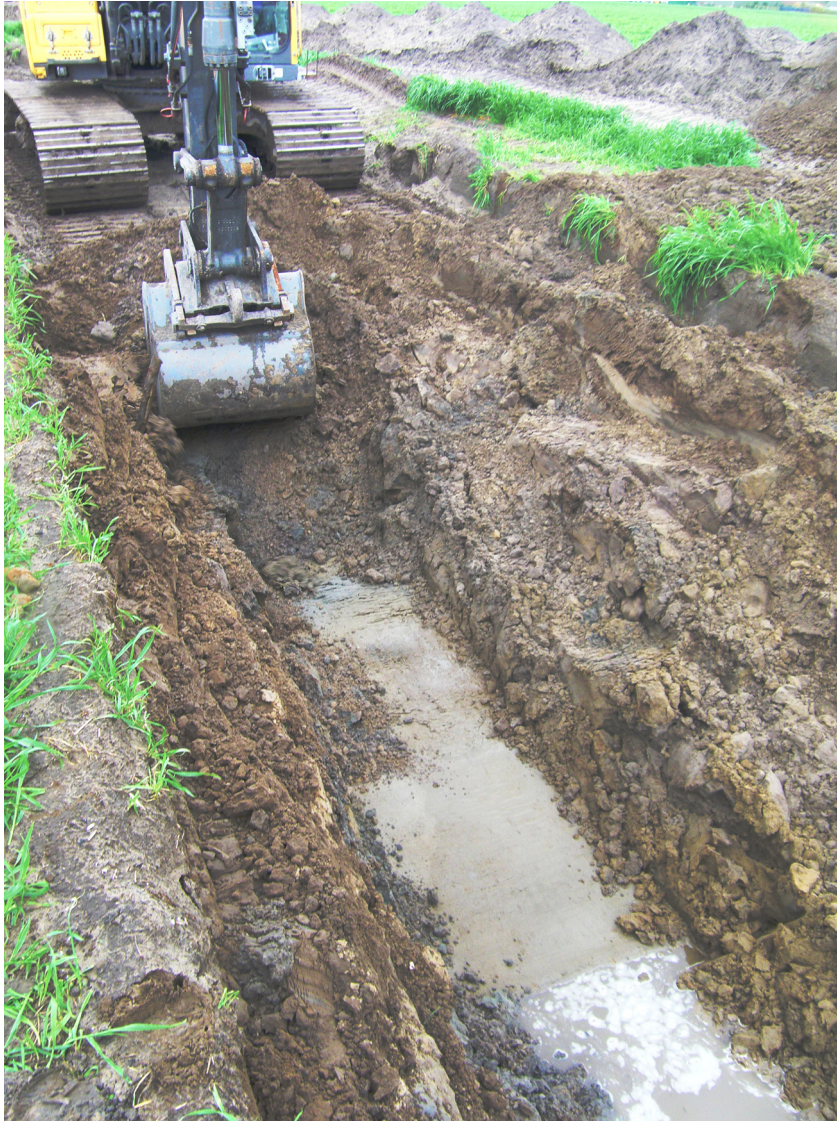
Figuur 3. De werkomstandigheden tijdens het onderzoek, waarbij op de voorgrond zichtbaar is dat sprake was van wateroverlast.
