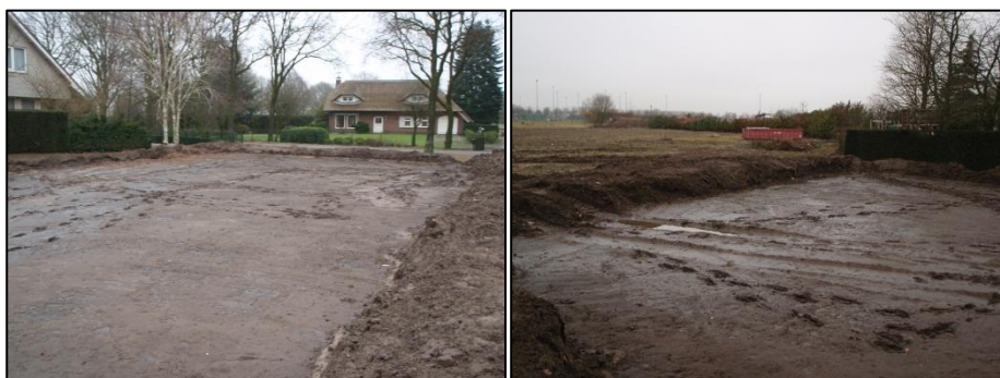
Figuur 3.2 Zicht op het plangebied. De linker foto is genomen vanuit het zuidwesten in noordoostelijke richting. De rechter foto is genomen vanuit het zuiden in noordwestelijke richting.
