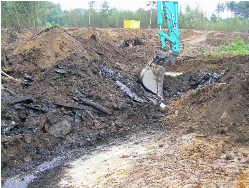
Figuur 8. Verwijderen van het in de gedempte Reg-geloopte gedumpte materiaal ter hoogte van boring 1 (zie kaartbijlage 1 voor de locatie).
