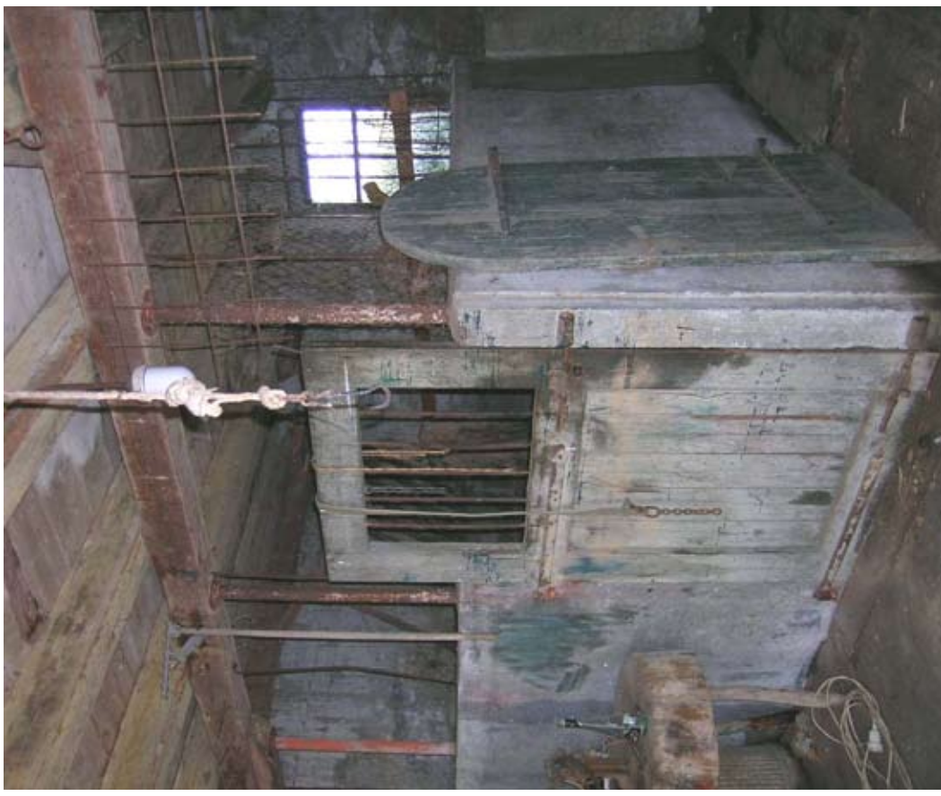
Afbeelding 105. Afbeelding in aansluiting op de vorige met de linker paardenbox en stalen buizen, die de onderslagbalk van de zolderbalklaag dragen.
