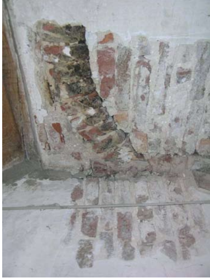
Afbeelding 133. Detail van de binnenhoek tussen de brandmuur van het voorhuis en de scheidingsmuur met het achterhuis. Rechts is een dichtzetting van een oudere – beroete – segmentboog zichtbaar. Deze boog komt uit op de zolder boven de keuken.
