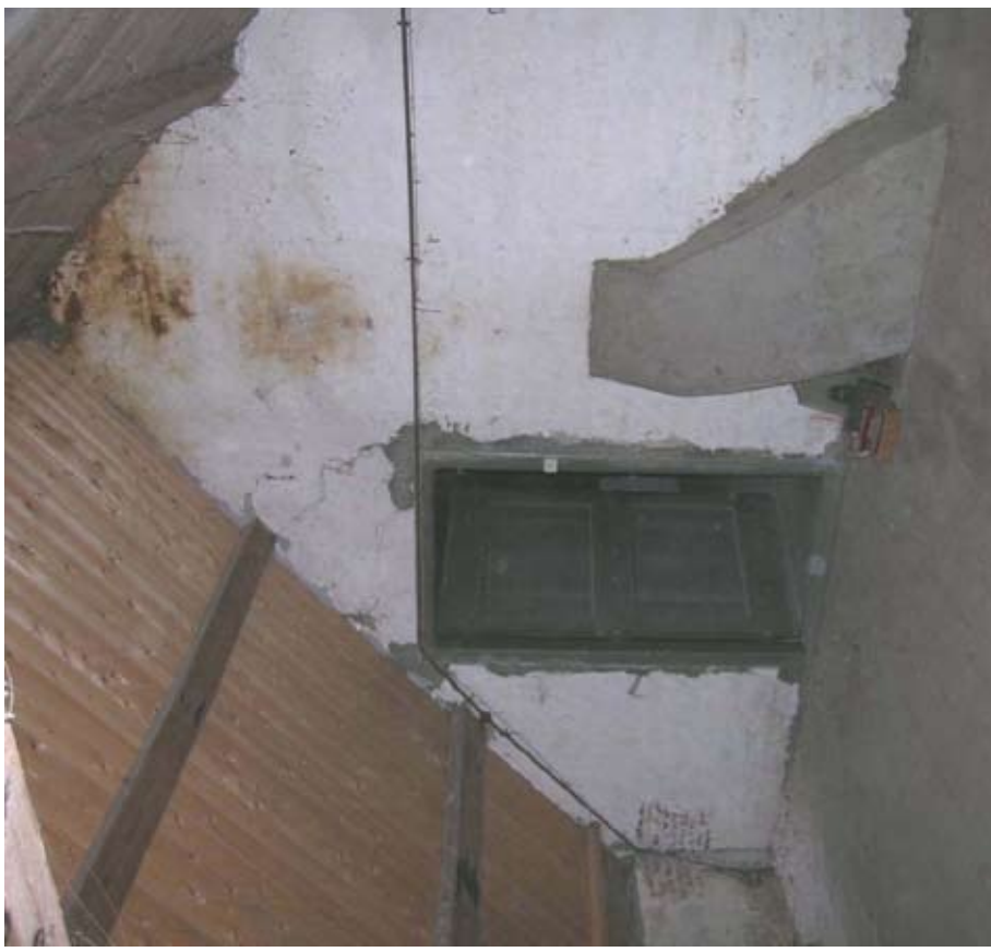
Afbeelding 141. Zicht vanaf de zolder boven de paardenstal in de richting van de brandmuur met het voorhuis. Links is een recentelijk vernieuwd deel van het dakbeschot zichtbaar.
