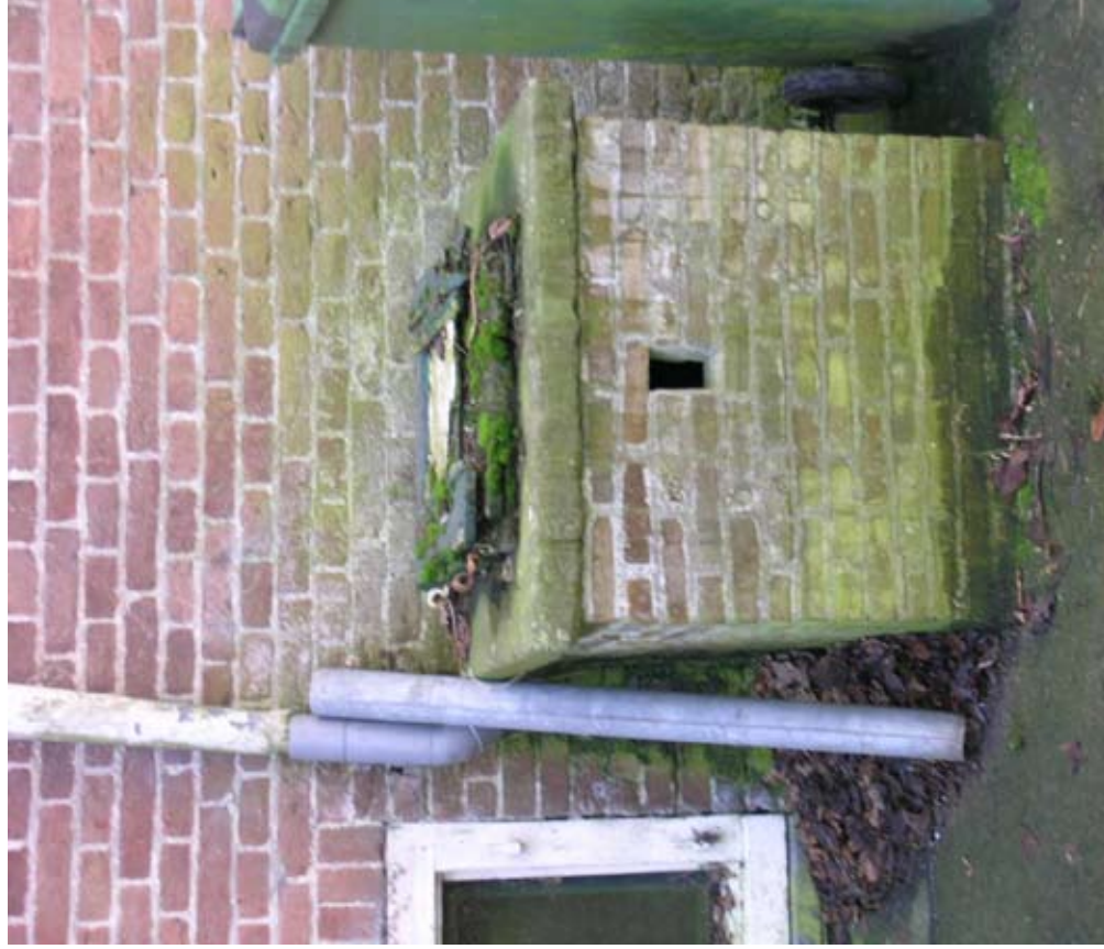
Afbeelding 67. Detail van de regenwatertank naast het kelderlicht.
