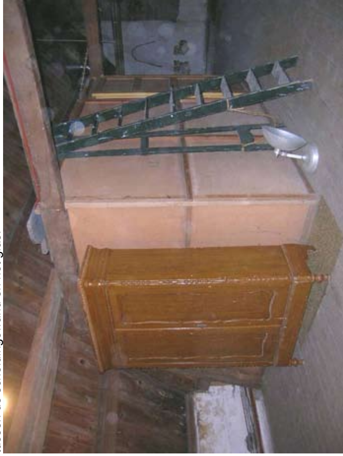
Afbeelding 129. Detail van de vorige afbeelding met de markante aansluiting tussen de scheidingswand en het glas.
