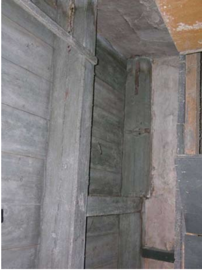
Afbeelding 102. Detail van de balklaag met raveling.
