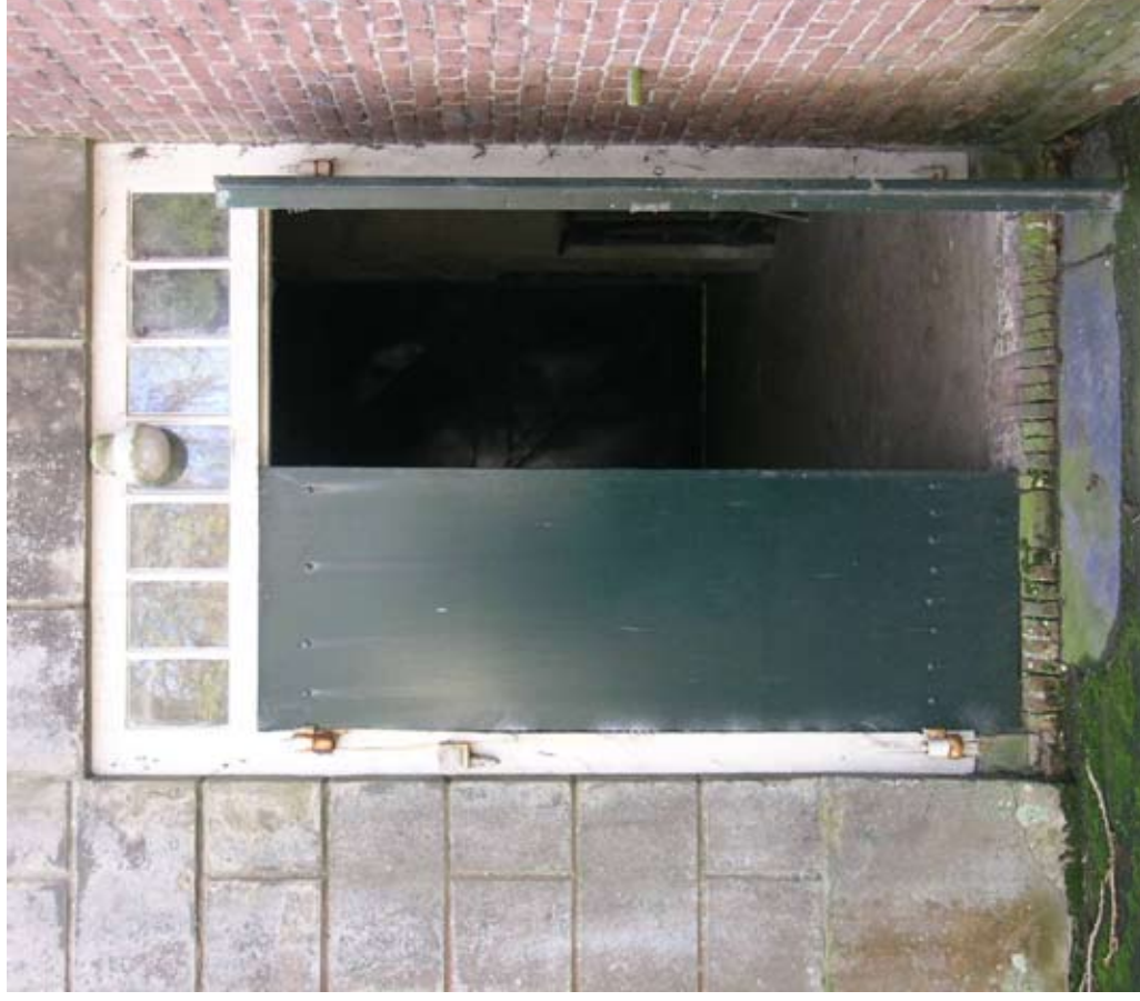
Afbeelding 51. Detail van de vorige afbeelding met het deurkozijn met bovenlicht, dat niet goed past in de blokverdeling van het pleisterwerk.
