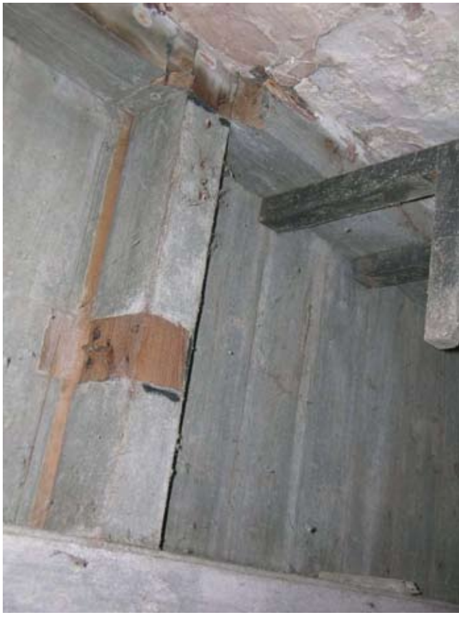
Afbeelding 103. Detail van de raveling bij de voormalige karmmolen.
