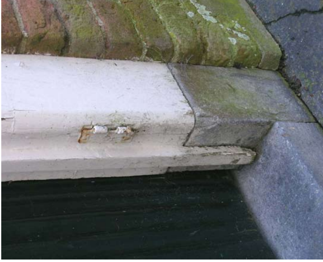
Afbeelding 59. Detail van de vorige afbeelding, met sporen van zomerdeur aan de buitenzijde (schamier). De kozijnstijl is aangescherfd.
