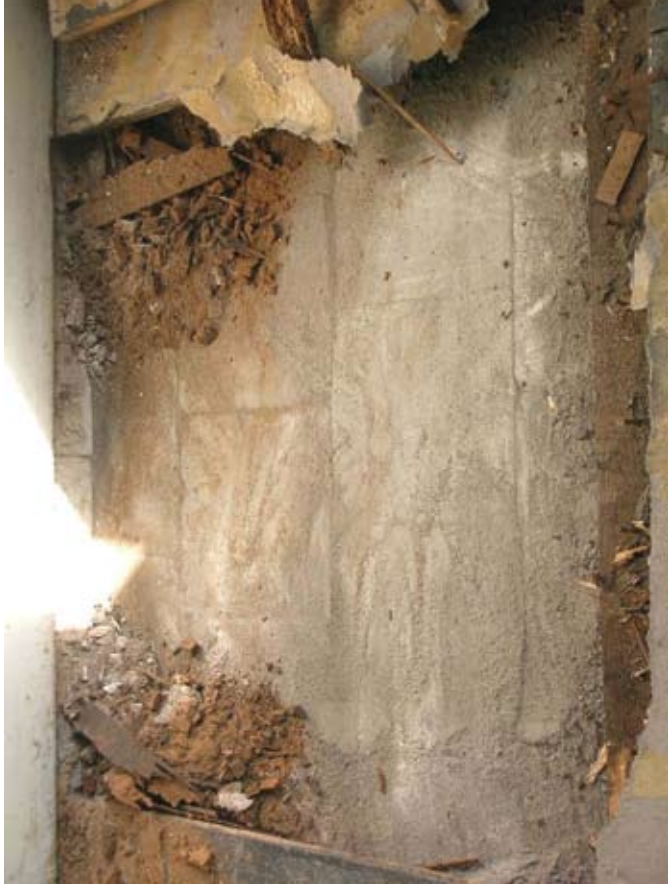
Afbeelding 79. Detail van de plavuizenvloer onder de huidige plankenvloer. Aan de bovenzijde is nog juist een strook wijjes als plinttegels zichtbaar.
