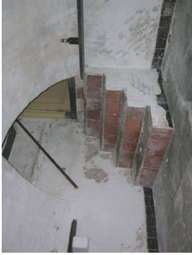
Afbeelding 121. Detail van de vorige afbeelding met de met rode en grijze plavuizen betegelde keldertrap.
