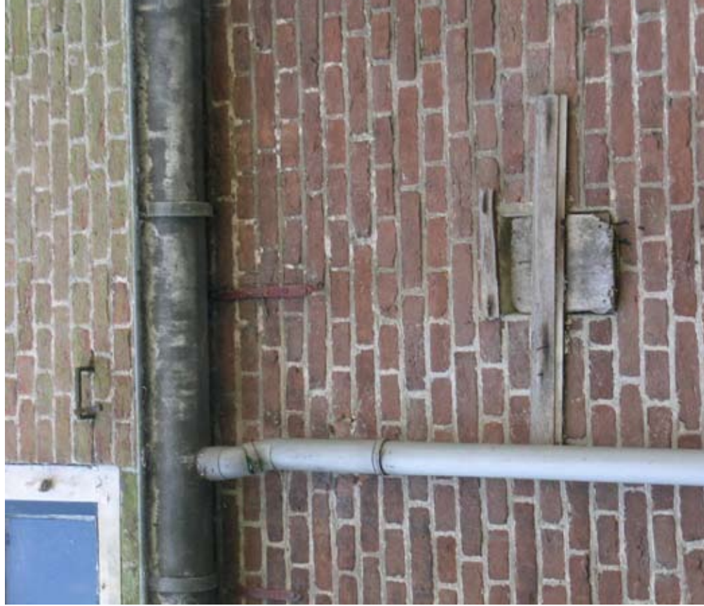
Afbeelding 66. Detail van een klein ventilatieuwje in de zijgevel, vermoedelijk behorende bij de achterliggende voormalige bedstede (thans badkamer).
