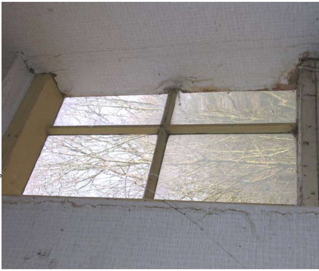
Afbeelding 128. Zicht in de twee kleine zolderkamers aan de rechterzijde van het achterhuis. De scheidingswand staat los voor het raam.
