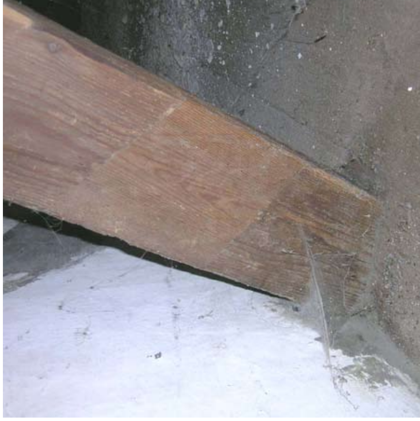
Afbeelding 137. Detail van één van de hergebruikte kreupele stijlen in de kap van het voorhuis. Het kleurverschil en de uitstukking duiden op hergebruik van een oudere kapconstructie.
