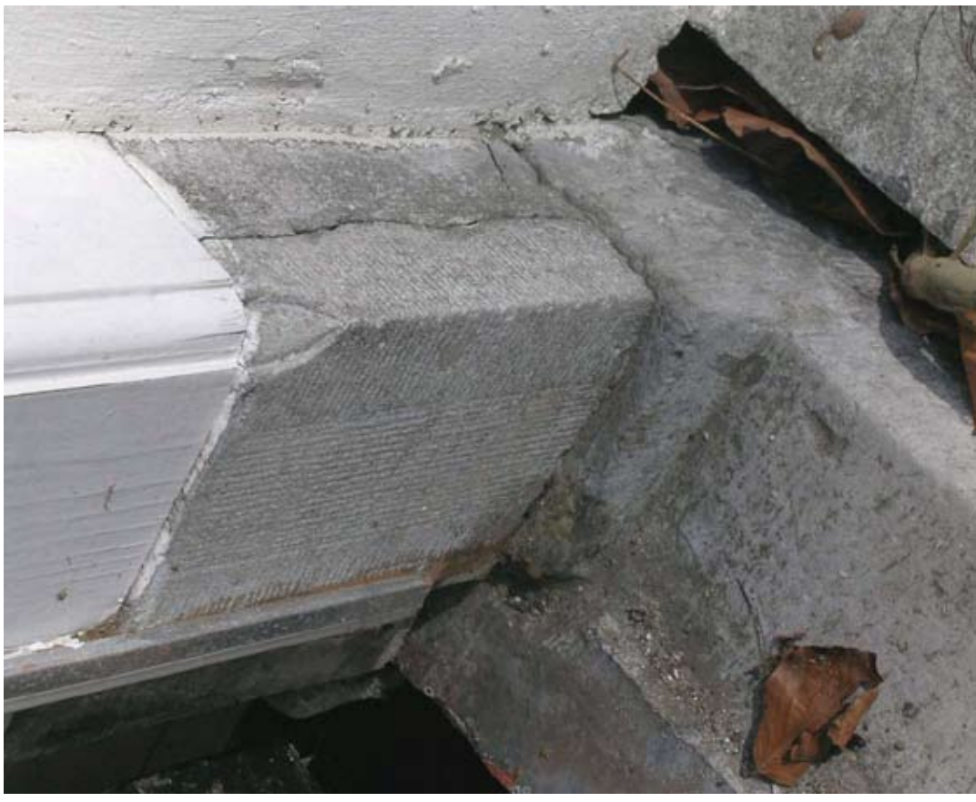
Afbeelding 69. Detail van de dorpel en neut, die niet op elkaar aansluiten.
