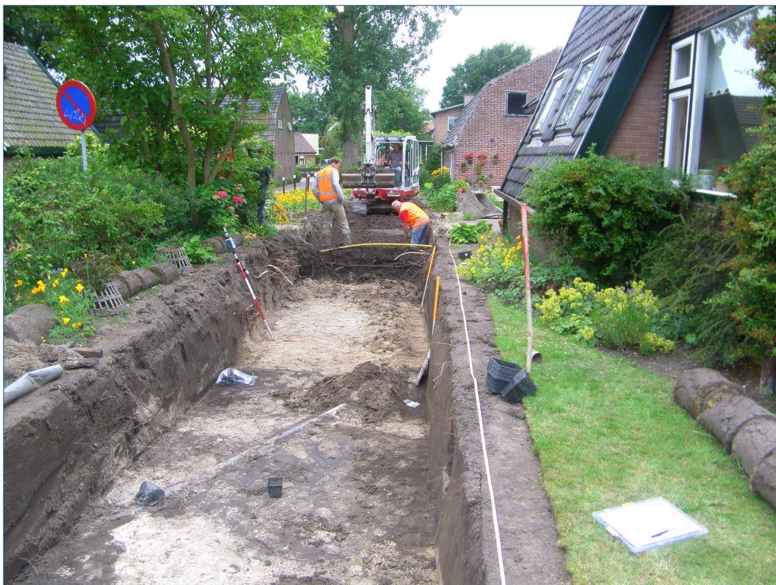
Figuur 13. Overzicht van de werkomstandigheden en de beperkte werkruimte ter plaatse van perceel Benedenweg 30 bij de aanleg van WP3. De foto is genomen richting het westen.
