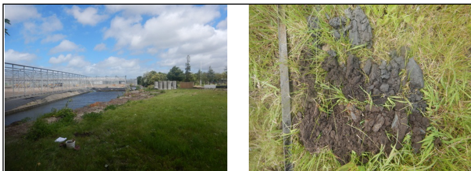
Figuur 2.2 Overzicht van het noordwestelijke deel van het plangebied en boring 4. De linker foto toont de huidige waterberging die gedempt gaat worden. De rechterfoto toont het uitgelegde bodemprofiel van boring 4.
