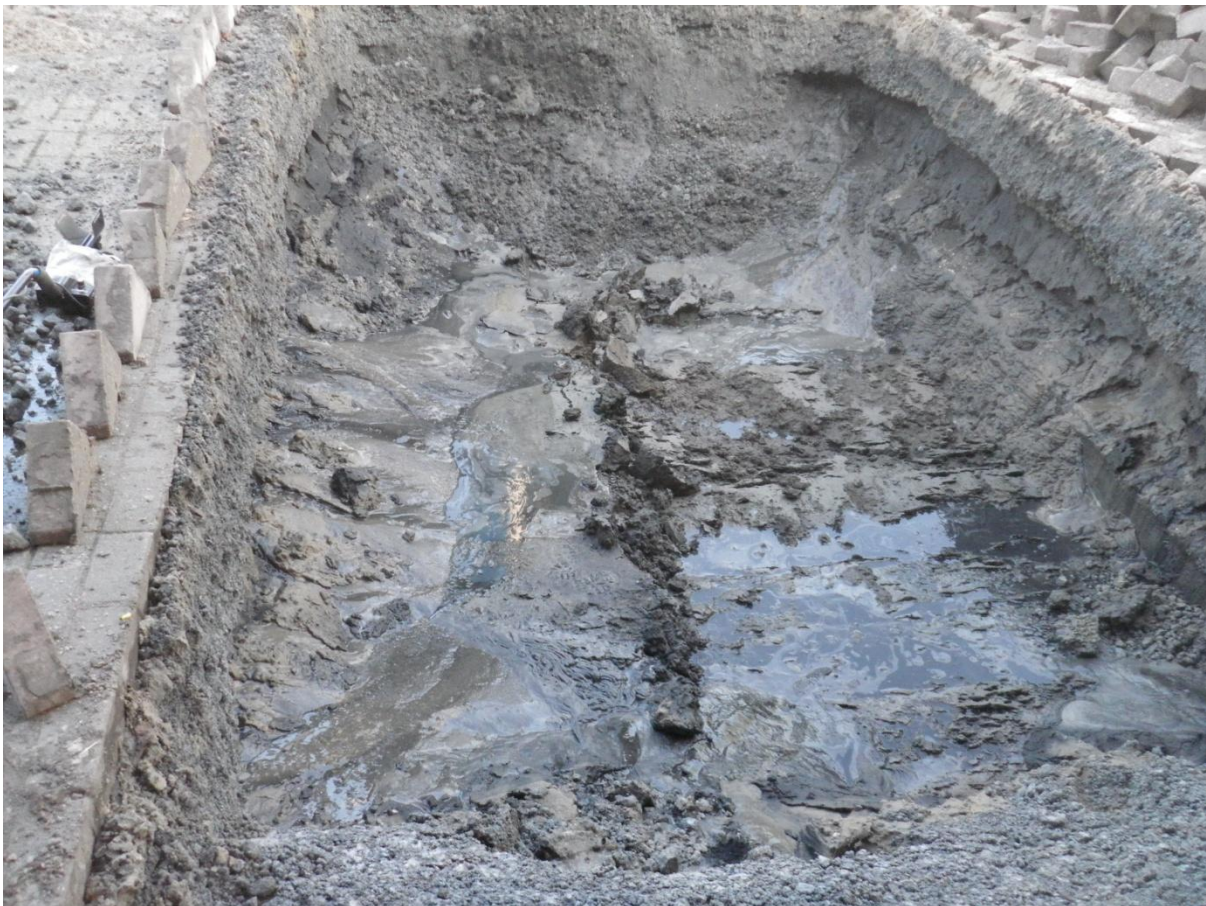
Figuur 3: Water en modder stromend uit de zijkanten van werkput 1.
