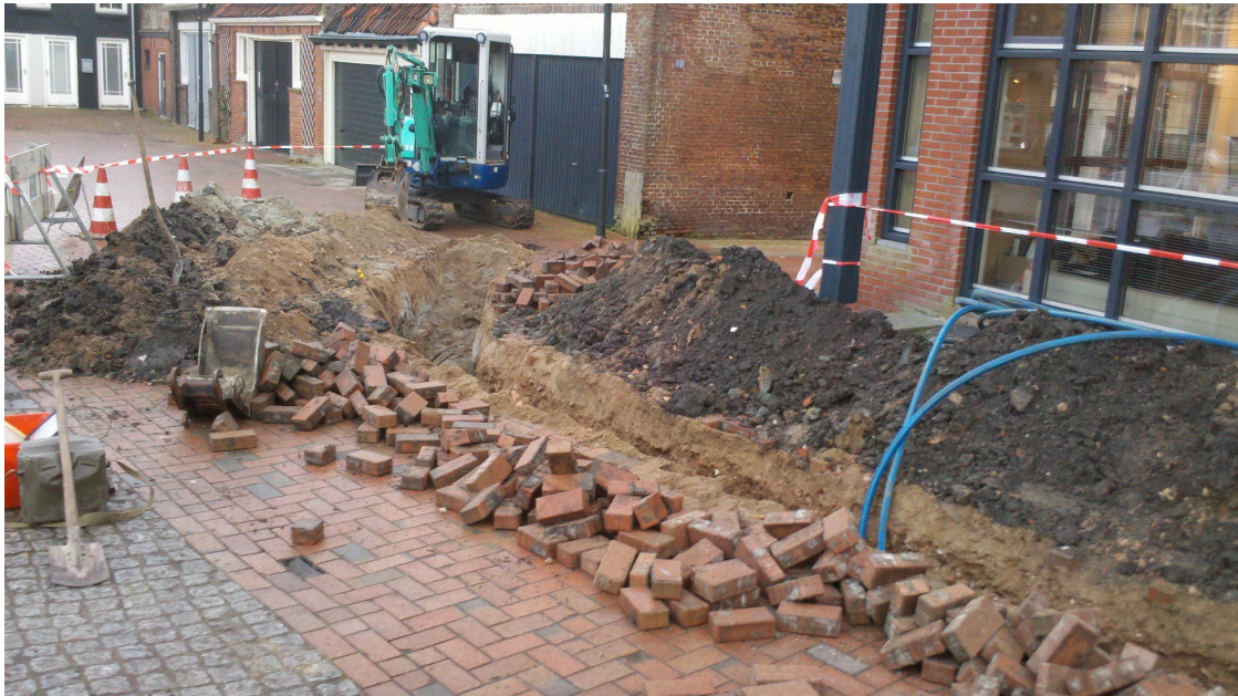
Figuur 26. Dokkum, Markt 2a & 2b: Foto van het uiterste noorden van de leidingsleuf. Hier is te zien dat de stort bestaat uit verstoorde, donkergrijze grond. Grijs terpklei is tijdens het graven niet of nauwelijks bereikt.
