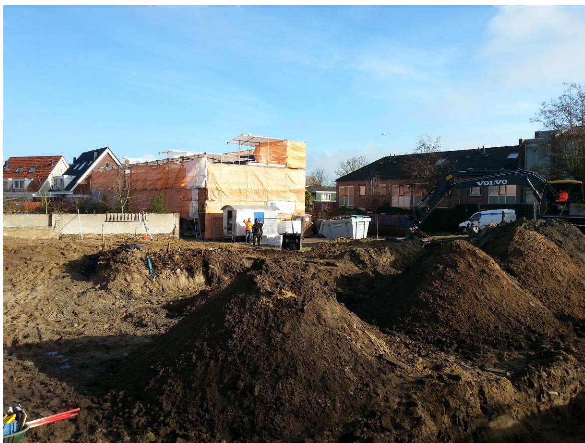
Afbeelding 1 Impressie van het terrein tijdens de archeologische begeleiding; foto van werkput 2 genomen vanuit het zuiden richting het noorden. Bron: foto Vestigia (03-02-2015).
