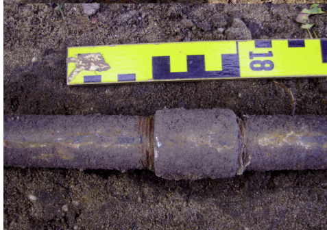
afbeelding 33, koppeling in een ijzeren waterleiding.
