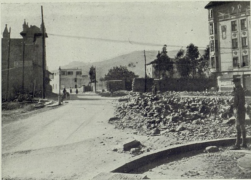
Estado de la Plaza del General Primo de Rivera al comienzo de las obras
