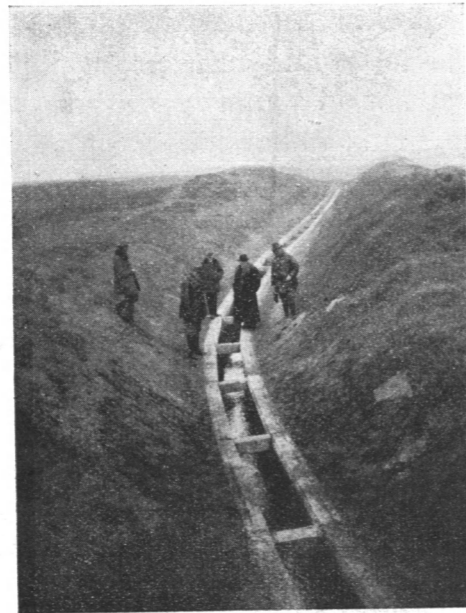
4. ábra. A becréti szivárgó csatorna vasbetondeszkákkal burkolt szakasza Kemece község határában.
