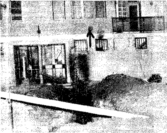
A 31. sz. épület homlokzatán a nyíl a robbanás helyét mutatja
