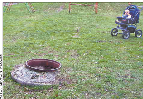
Odkryta studzienka na placu zabaw, to widok mrozący krew w żyłach.
