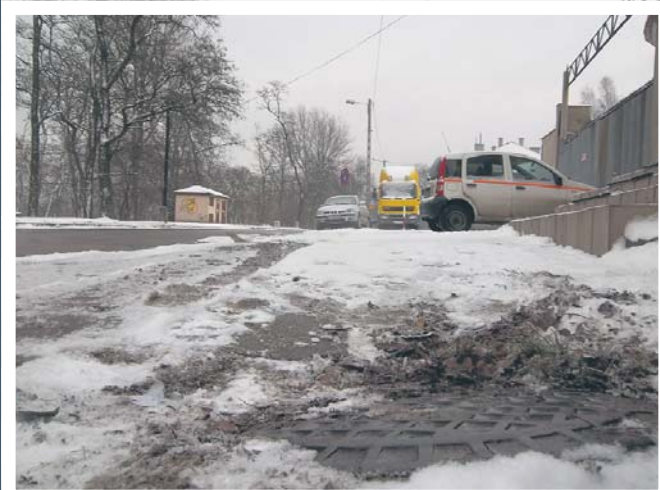
UL. KOSZAROWA 6. Kolejny zapadnięty kanał
