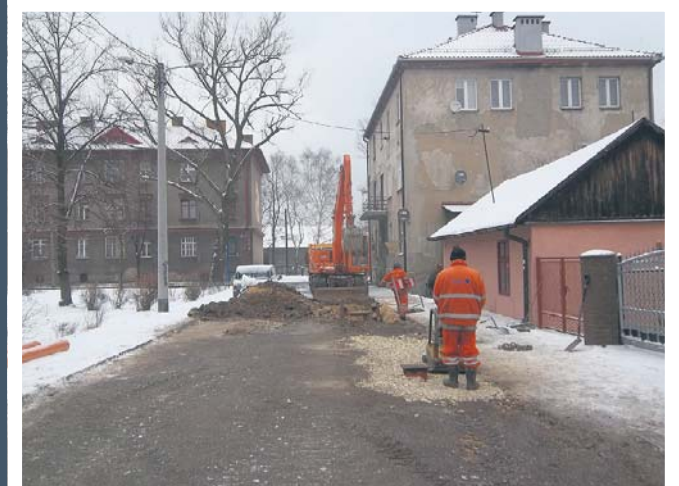
UL. DASZYŃSKIEGO 10. Ciekawy, czy po wymianie kanalizacji zostawią dziurę?
