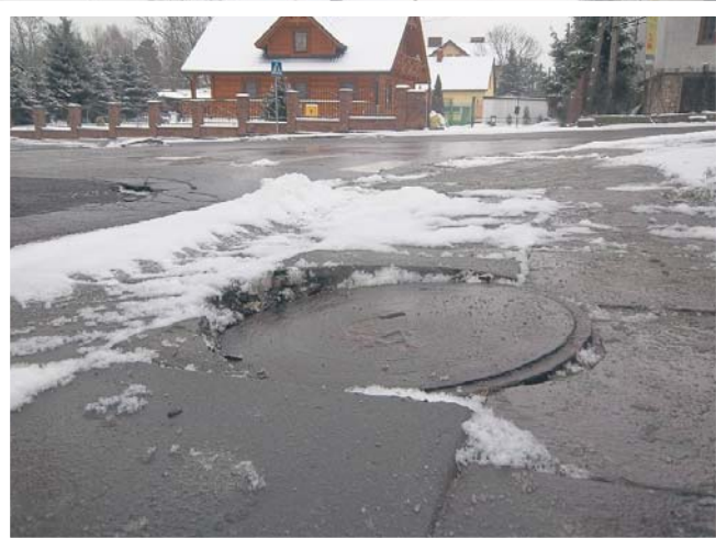
UL. KOSZAROWA 1. Zapadnięty kanał
