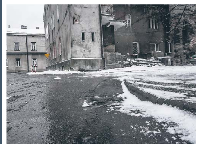
UL. WĄSKA 1. Kolejny zapadnięty kanał
