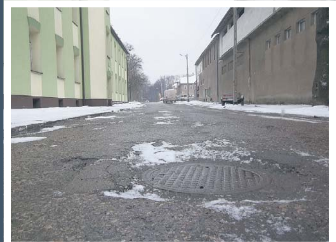
UL. KOSZAROWA 8. I jeszcze jeden zapadnięty kanał
