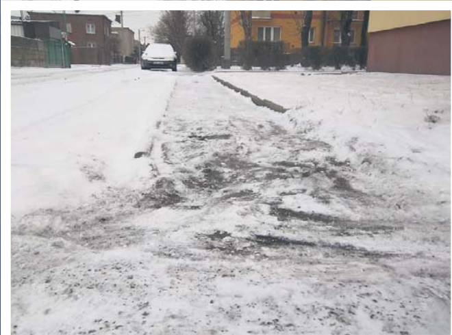
UL. OGRODOWA 6. Ruina a nie chodnik
