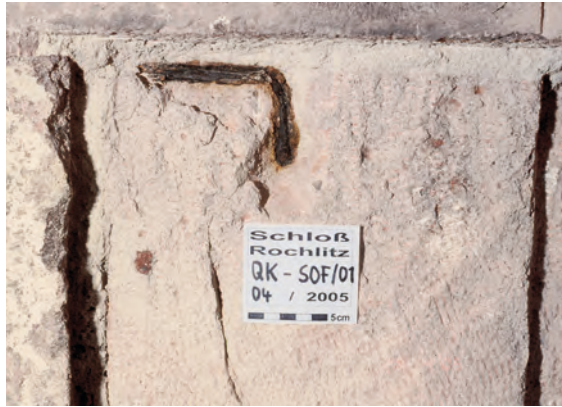
Abb. 17 Schlosskapelle, spätgotischer Ostabschluss, Brüstungs- mauerwerk, Eisenklammer zur Fixierung der Werkstein- quader.
