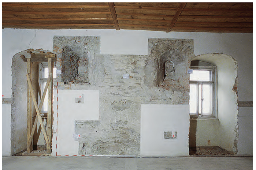
Abb. 4 Südwand von »Turmzimmer 1« im ersten Obergeschoss des ehemaligen romanischen Torturmes. Zustand nach Freilegung der bauzeitlichen Rundbogenfester (um/nach 1175).
