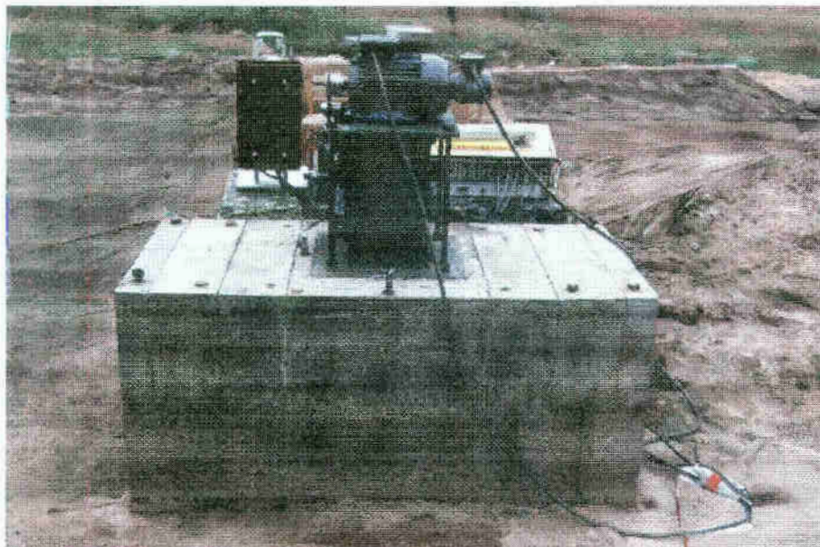
Rys. 3.8. Blok fundamentowy o wymiarach L \times B \times H = 1,6 \times 0,8 \times 0,7 m, zagłębienie h_p = 0,0 m, wzbudzenie poziome
