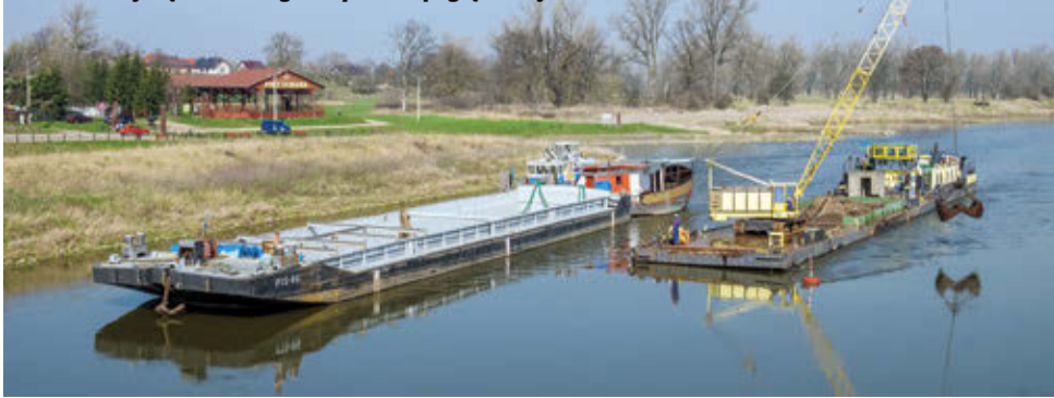
Usunięto kamienie i piach zalegający już od parunastu lat w środkowej części rzeczno-koryta oraz pogłębiono je
